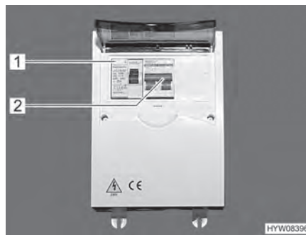
Bild 116 230 V-säkringslåda med ledningsskydds-brytare och FI-brytare
