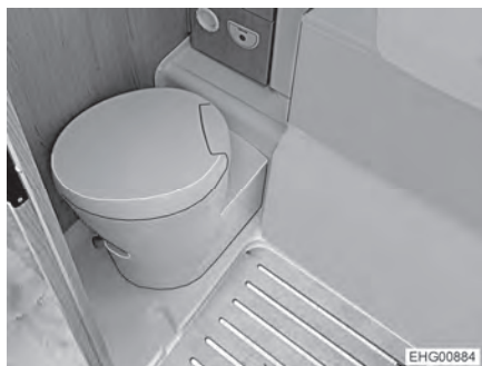
Bild 152 Toalettstol, vriden mot väggen
