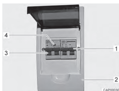
Bild 78 Ledningsskyddsbytare och FI-brytare (230 V-säkringslåda)
