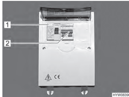
Fig. 116 Caja de fusibles de 230 V con interruptor de protección de línea e interruptor FI
