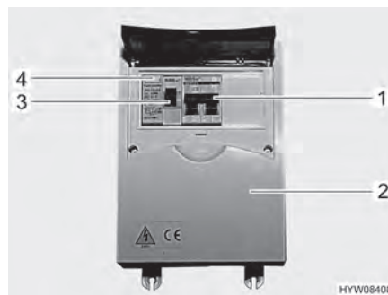
Fig. 102 Caja de fusibles de 230 V con interruptor de protección de línea e interruptor FI
