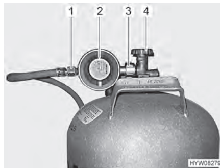
Fig. 72 Conexión de la bombona de gas
